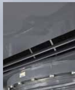
ルーバータイプの排風口
