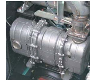
排ガス後処理装置
